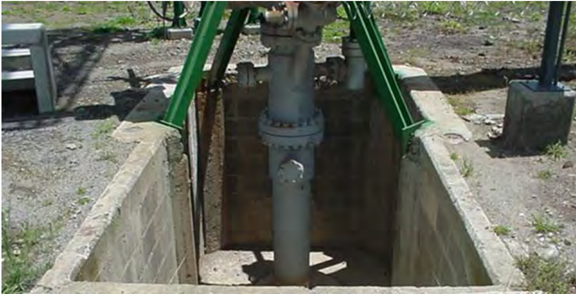
Fotografía 2 Contrapozo. Nótese el sistema utilizado para unir el ademe con el cabezal de válvulas para el control del pozo.
