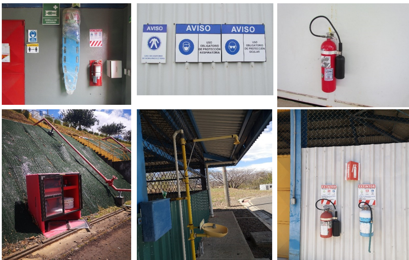
Figura 29. Ejemplos de equipos para atención de emergencias disponibles en Planta y Campo Geotérmico
