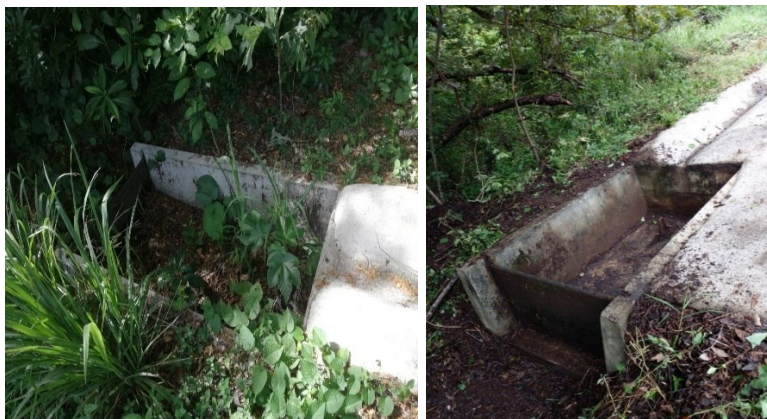
Figura 36. Limpieza de sedimentadores durante inspección de sistemas de evacuación pluvial. CGP, mayo y junio 2023.
