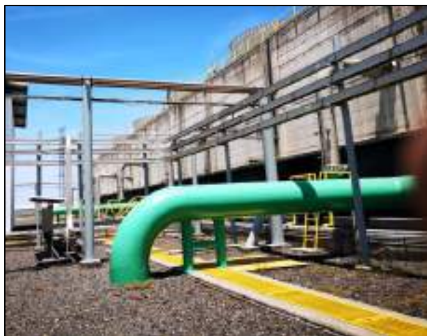
Figura 19. Sistema de drenajes de condensado
