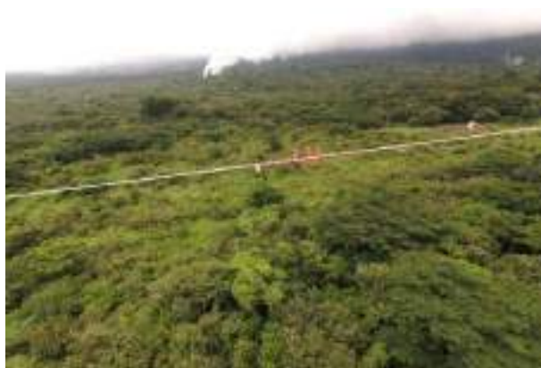
Figura 54. Dispersores para aves instalados en LT.
