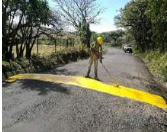
Figura 69. Reductor de velocidad, San Jorge
