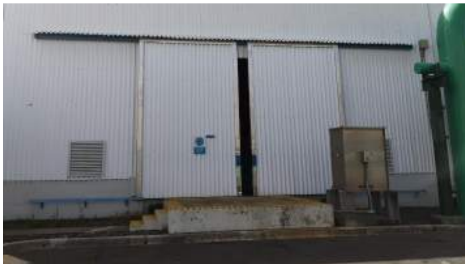
Figura 78. OEC I Pailas I. Puertas cerradas, máquina en operación
