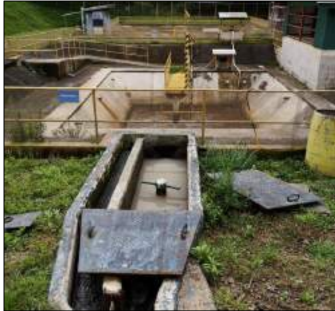
Figura 12. Planta de Tratamiento de Aguas Residuales en operación
