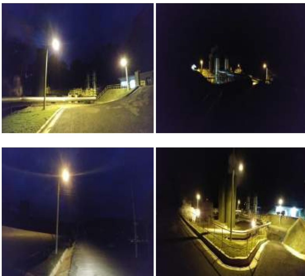
Figura 55. Iluminación plazoletas y caminos PG Pailas
