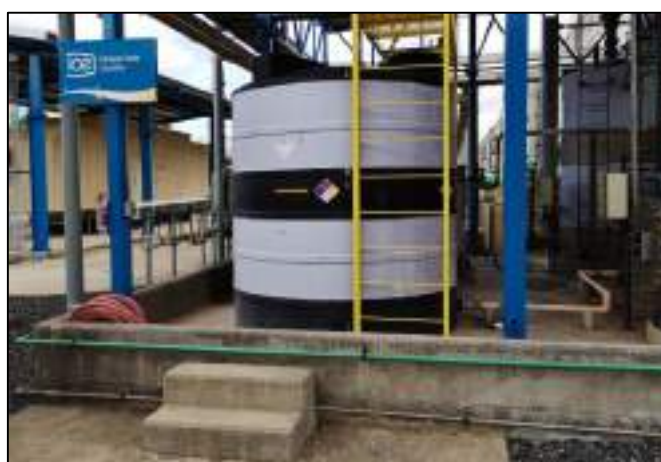
Figura 18. Tanque de soda cáustica con muros y drenajes para la contención de derrames
