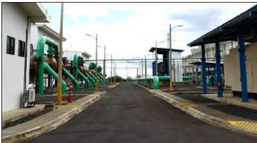
Figura 73. Vista general del acceso principal a las unidades de generación de Unidad I
