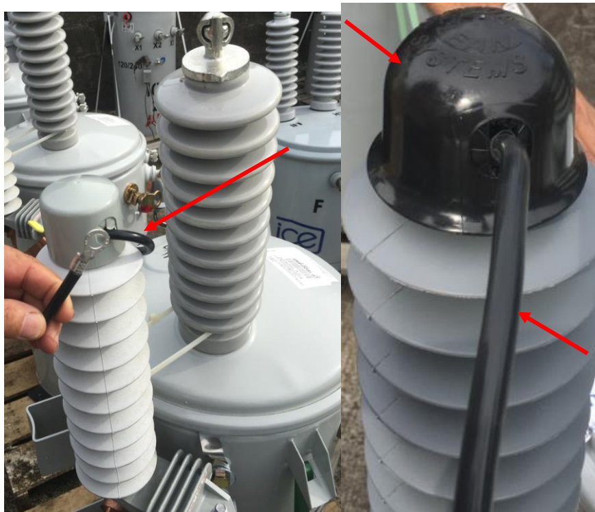
Imagen 7. Imagen representativa de la forma de conexión terminal primario con terminal de pararrayos
