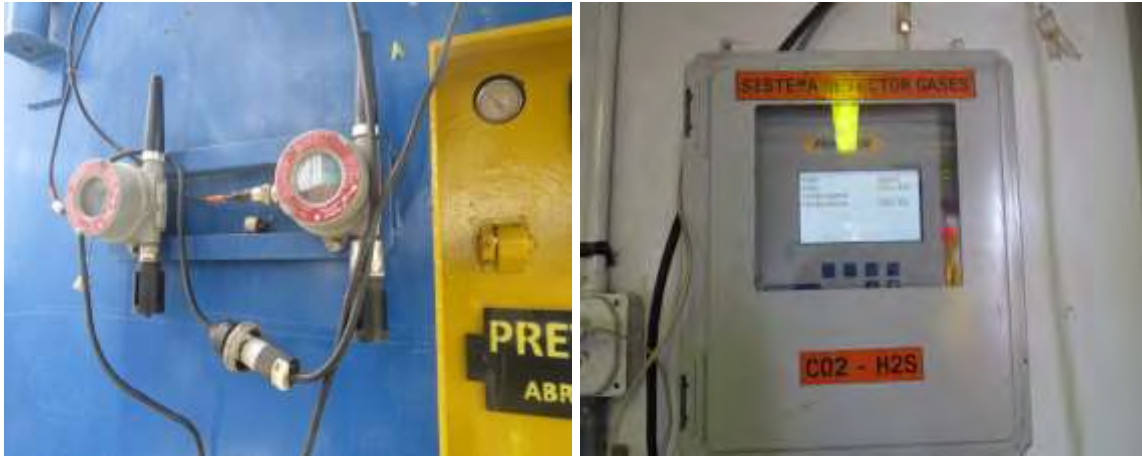
Figura 17. Algunos de los detectores fijos con sistema de alarmas audibles de H 2 S y CO 2 .
