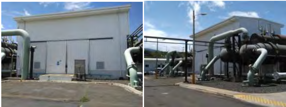
Figura 174. Aislamiento térmico y acústico de la caseta de turbina está en buen estado.
