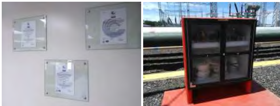
Figura 159. Certificados de calidad, ambiente y riesgos vigentes y gabinete con equipo contra incendios en buen estado, con mangueras, pitones y herramientas.
