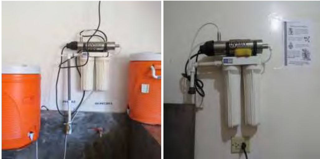
Figura 26. Sitios rotulados para agua potable y no potable.
