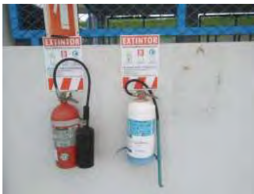
Figura 158. Extintores ubicados en el sector de la bodega de químicos. Se está haciendo un cajón nuevo para las hojas de seguridad, los extintores están cargados.
