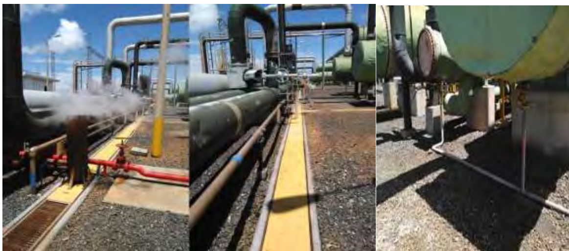
Figura 172. Tanque de drenajes de condensado buen estado, 12 de junio del 2017.
