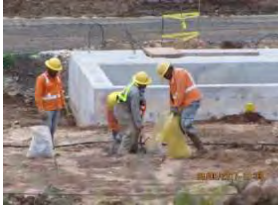
Figura 46. Simulacro de atención de derrames en Casa Maquinas II.
