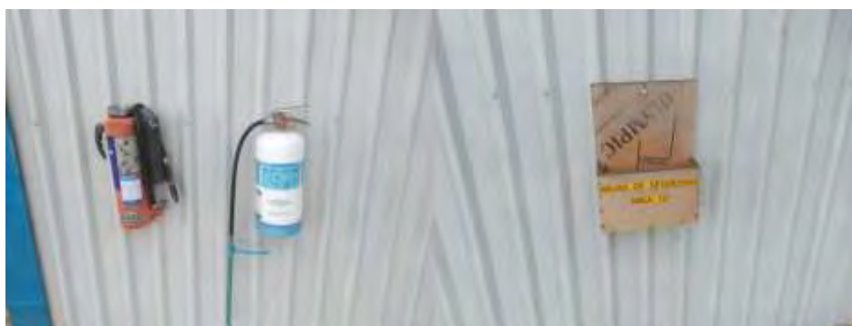
Figura 152. Evidencia de extintor con amarra suelta y ausencia de hojas de seguridad.
