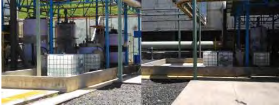
Figura 161. Sistema de soda con muros de contención de derrames.
