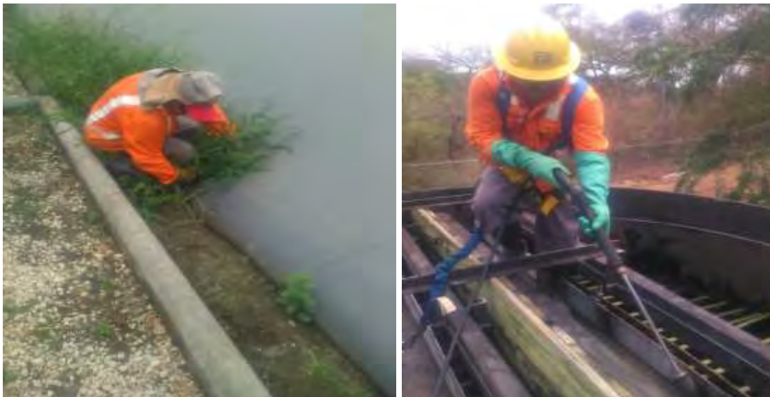
Figura 41. Limpieza y mantenimiento del STAR del Campamento.
