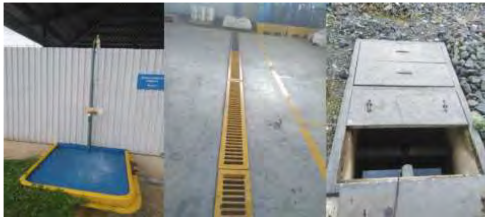
Figura 156. Vista de la ducha, el canal de drenaje y el tanque de contención de derrames. Vista interior de la de la bodega de sustancias inflamables.
