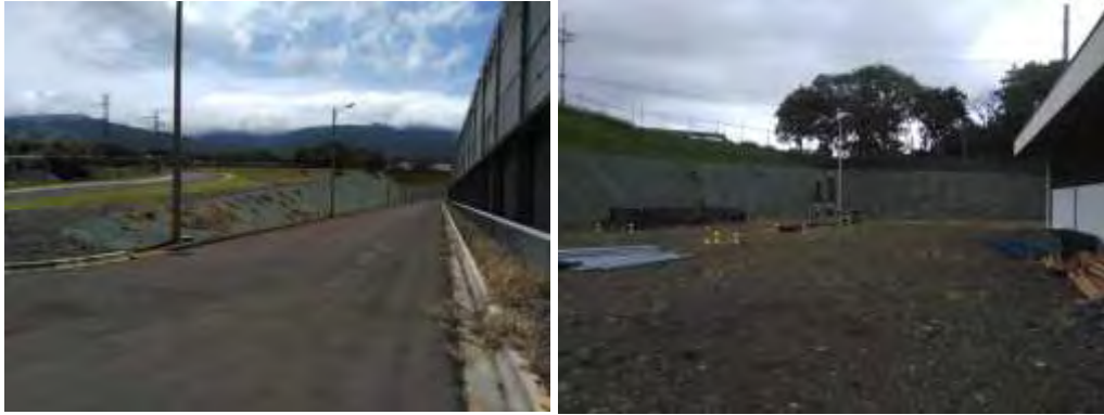
Figura 175. Taludes estabilizados con geo-membranas sintéticas en la Planta Geotérmica Pailas I, en buen estado.
