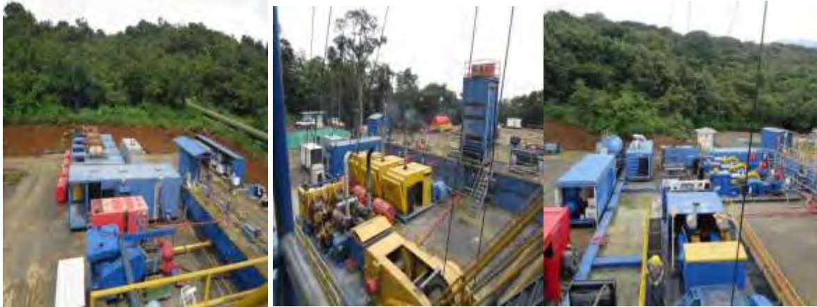
Figura 15. Sistemas de escape de perforadoras National, Cardwell y Kpem.
