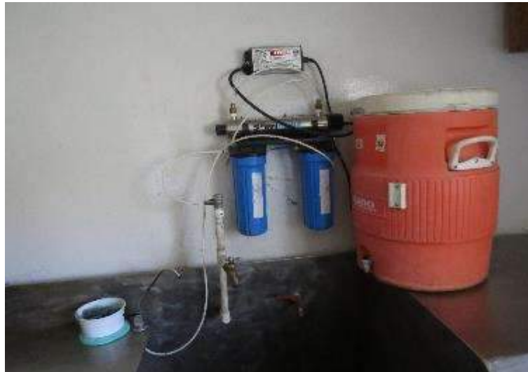
Figura 26. Filtro de purificación de agua mediante luz ultravioleta.
