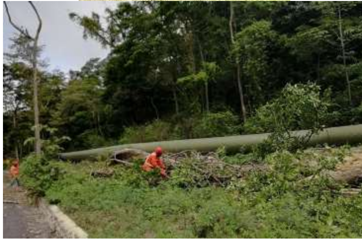
Figura 45. Corta de árboles con riesgo de caída en los caminos internos de Pailas II.
