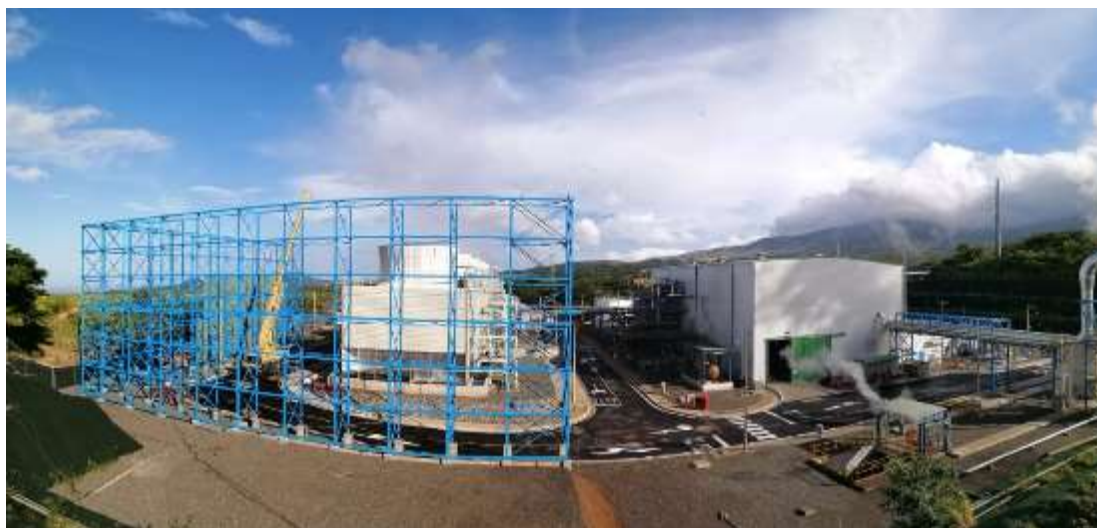
Figura 119. Barrera sónica Casa Máquinas Pailas II.
