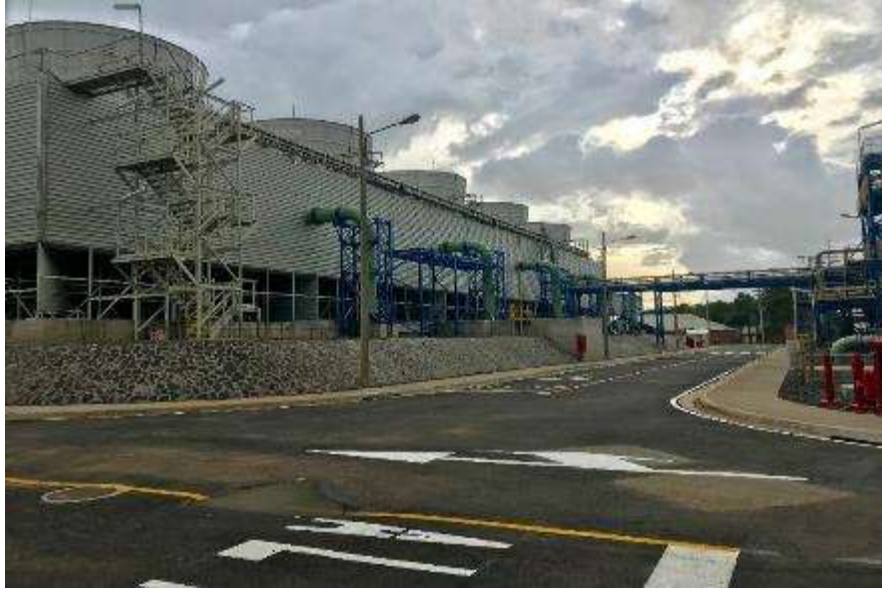
Figura 132. Vista general externa, área torre de enfriamiento y eyectores.
