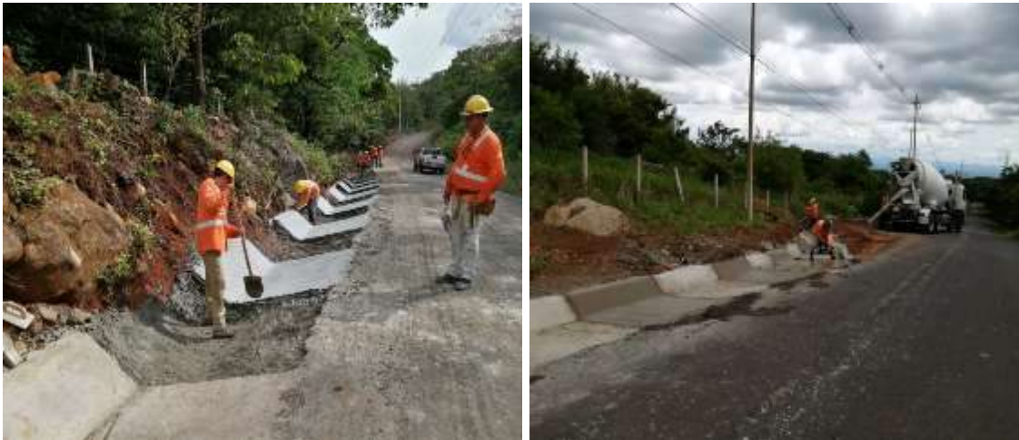
Figura 133. Manejos de agua pluviales, PG Las Pailas II.
