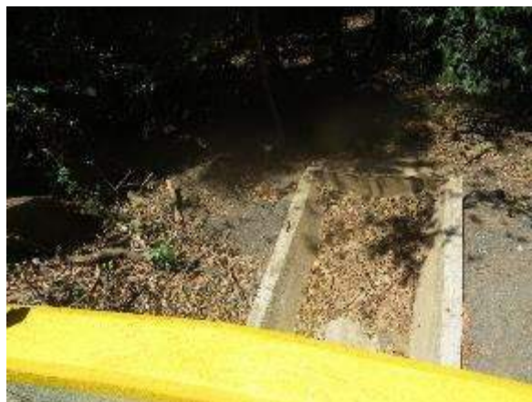
Figura 29. Sedimentador en el Proyecto Geotérmico Las Pailas Unidad II.
