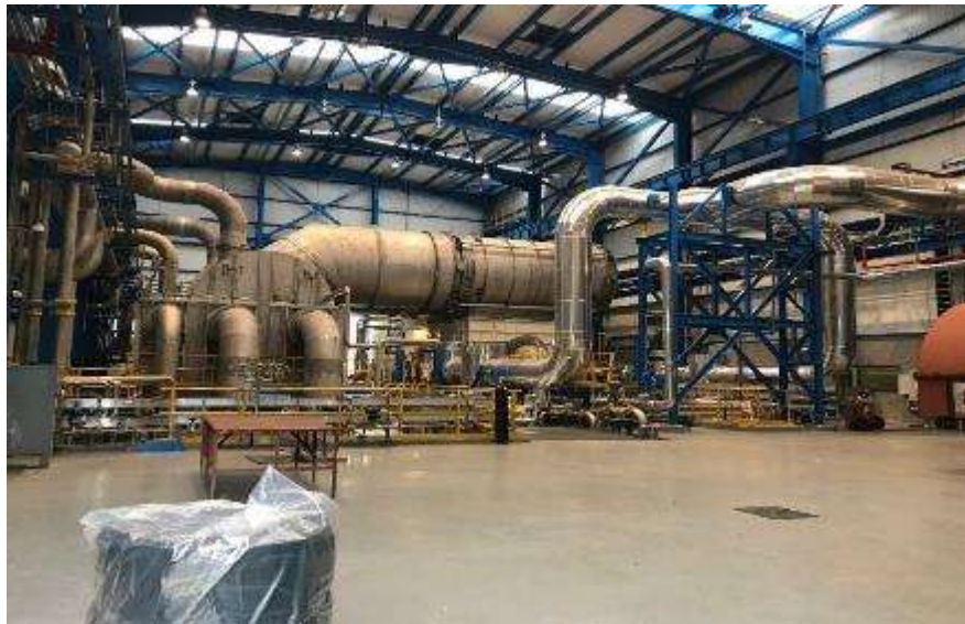
Figura 131. Vista interna general acabado final en sala de turbina.
