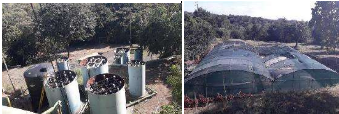
Figura 33. Planta de tratamiento de aguas residuales del Plantel de Curubandé.
