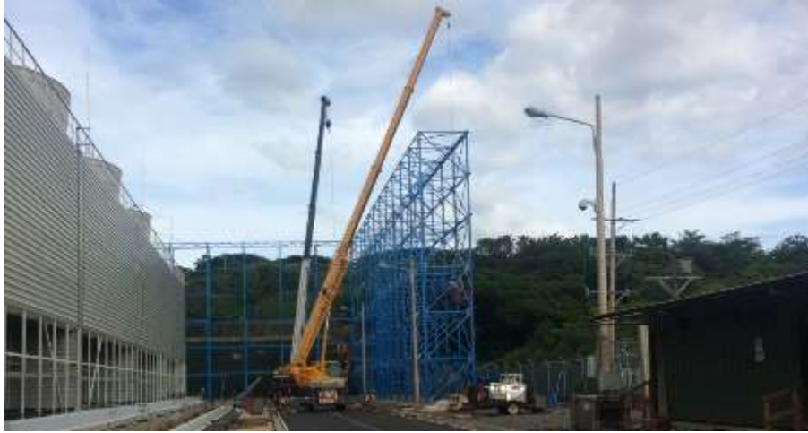
Figura 42. Barrera sónica Casa de Máquinas Las Pailas II.
