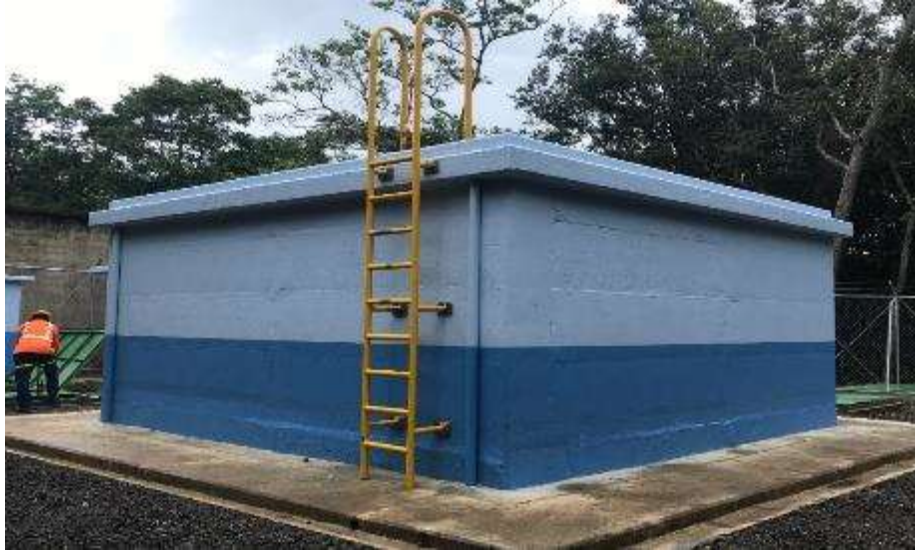
Figura 137. Tanque de almacenamiento.
