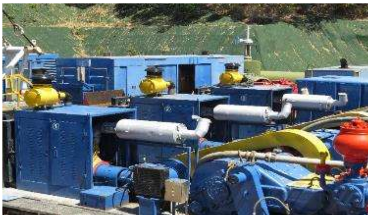
Figura 12: Sistemas de escape de equipos de perforación Cardwell KB-700.
