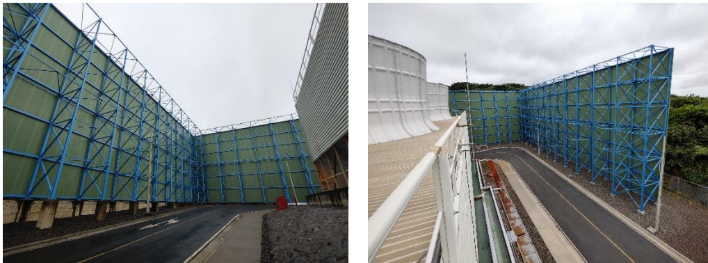
Figura 31 Pantalla sónica en Unidad II para disminuir el efecto del sonido a sitios cercanos
