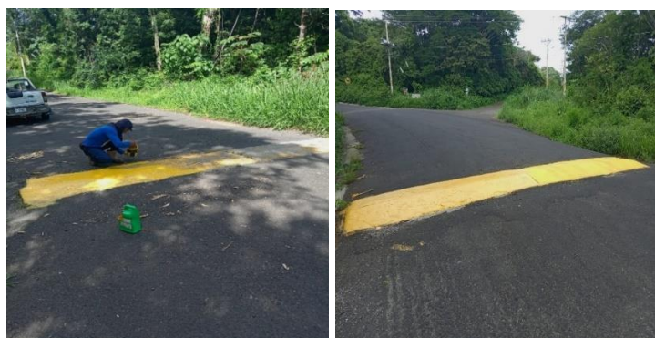
Figura 54. Mantenimiento de reductores de velocidad y señalización. Campo Geotérmico Las Pailas. II Semestre 2023.
