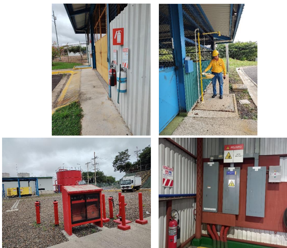
Figura 23. Ejemplos de equipos para atención de emergencias disponibles en Planta y Campo Geotérmico
