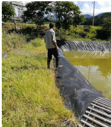
Figura 53. Revisión de sistemas de impermeabilización de las lagunas. Campo Geotérmico Las Pailas. II Semestre 2023.
