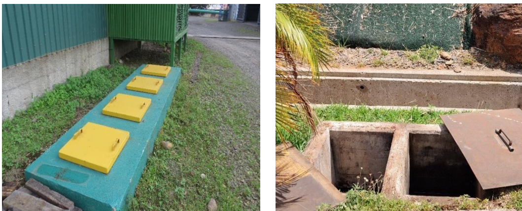
Figura 16. Trampas para aguas oleaginosas de talleres del campo geotérmico y Planta.
