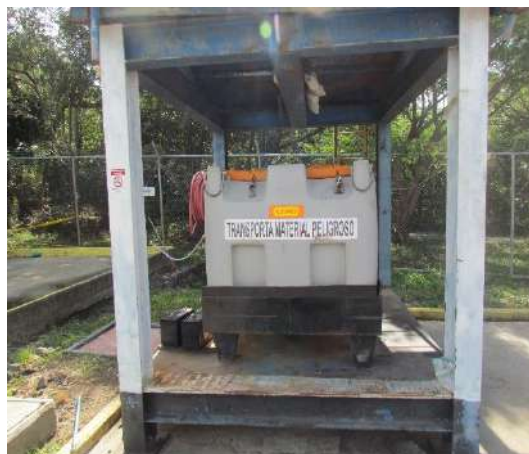
Figura 26 Tanqueta y equipos dispensadores utilizados para el despacho de combustibles
