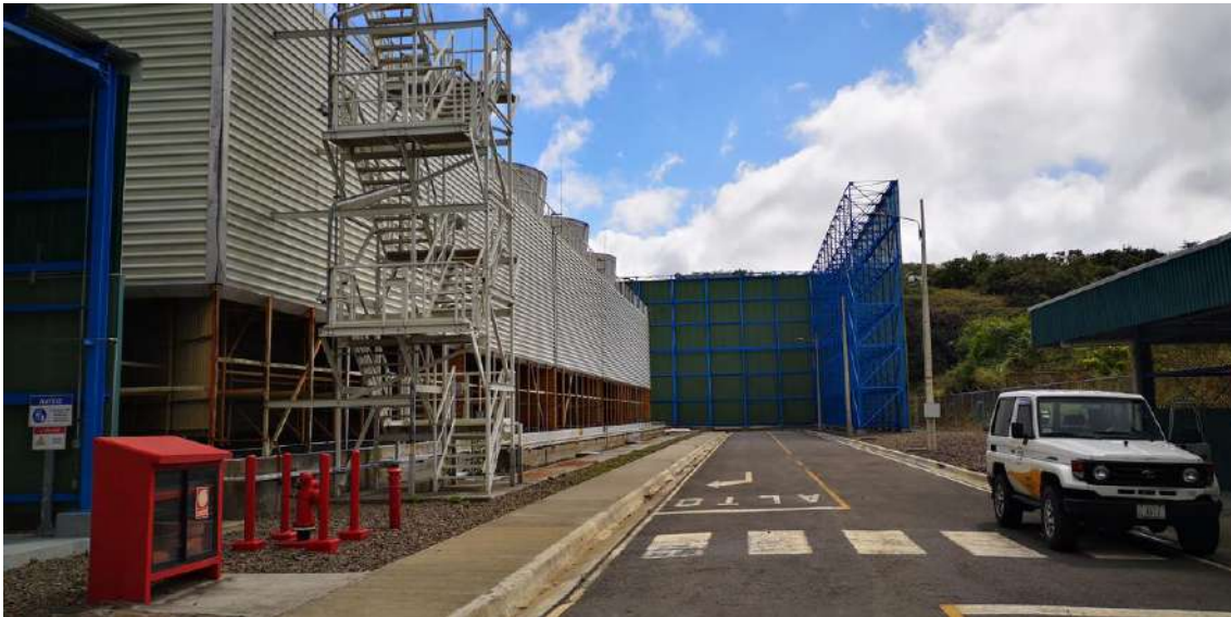
Figura 42 Pantalla sónica instalada en Planta Pailas Unidad II
