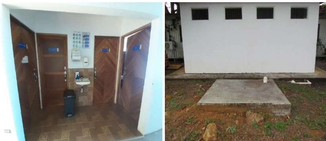
Figura 19. Tanques sépticos y servicios sanitarios utilizados en el CG Las Pailas.
