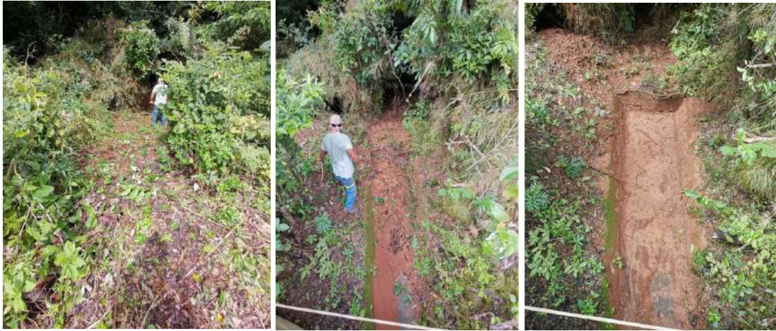
Figura 45. Limpieza de sedimentadores durante inspección de sistemas de evacuación pluvial. Campo Geotérmico Las Pailas. Agosto, 2021
