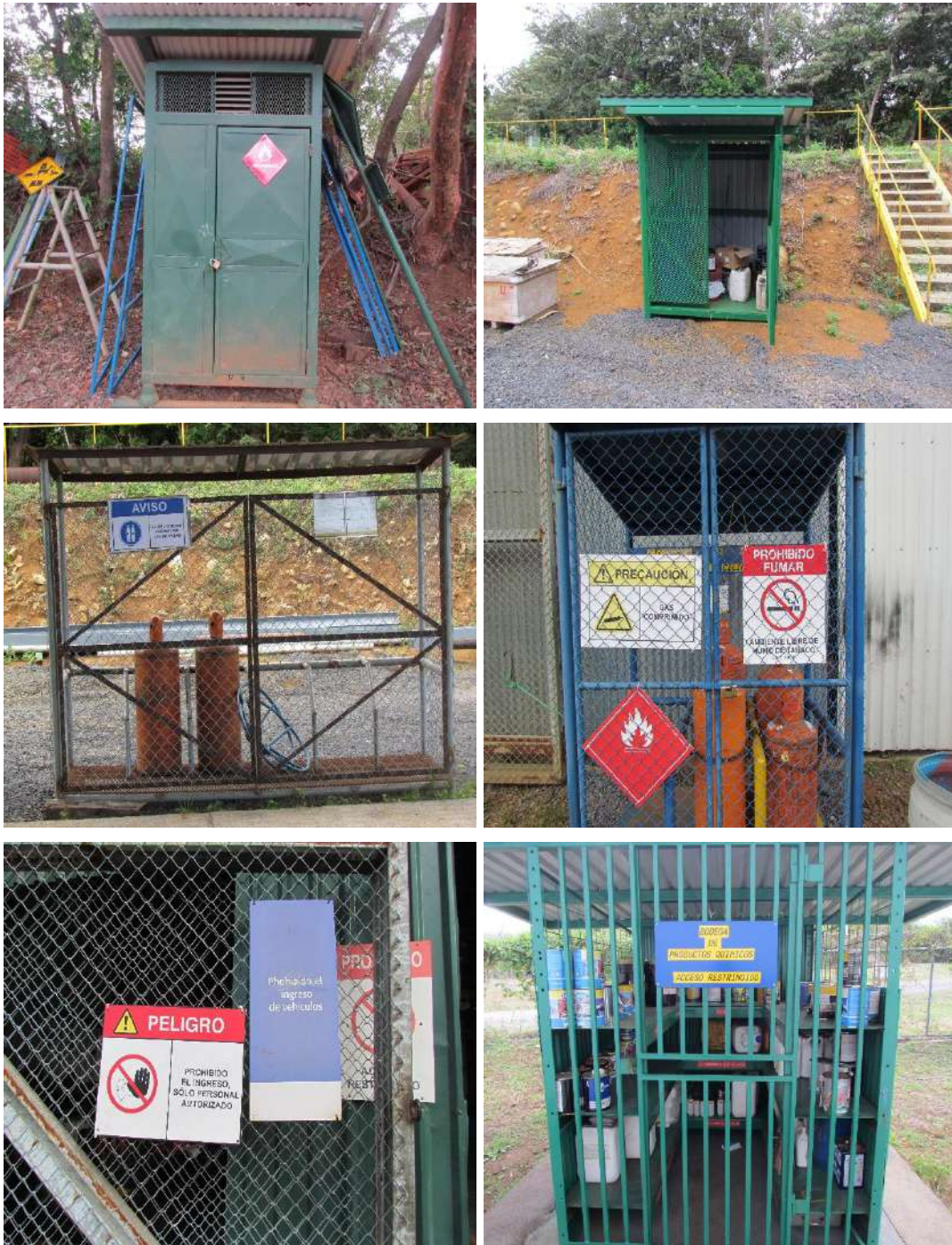
Figura 24 Áreas de almacenamiento para sustancias peligrosas en el CG Pailas
