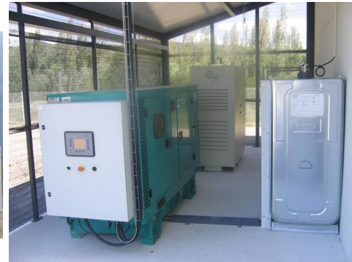
G- Generador Diesel 55 kVA y Microturbina de Gas 30 kW (además del aprovechamiento térmico)
