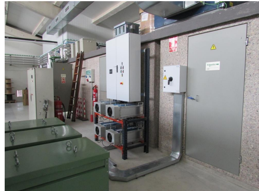
S- Supercondensadores 30 kW, 45 sg
