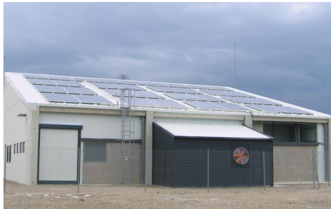
G- Instalación Fotovoltaica 25 kWp
