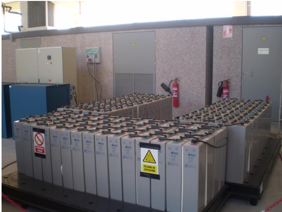
S- Baterías de Plomo-Ácido, 50 kW x 2 horas
