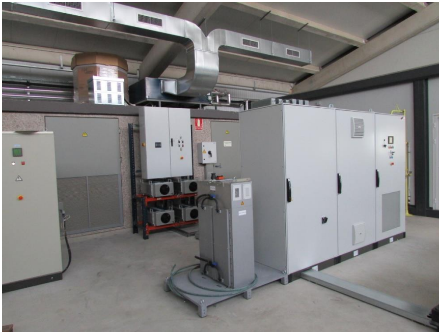
S- Baterías de Ion-Litio, 50 kW x 1/2 hora
