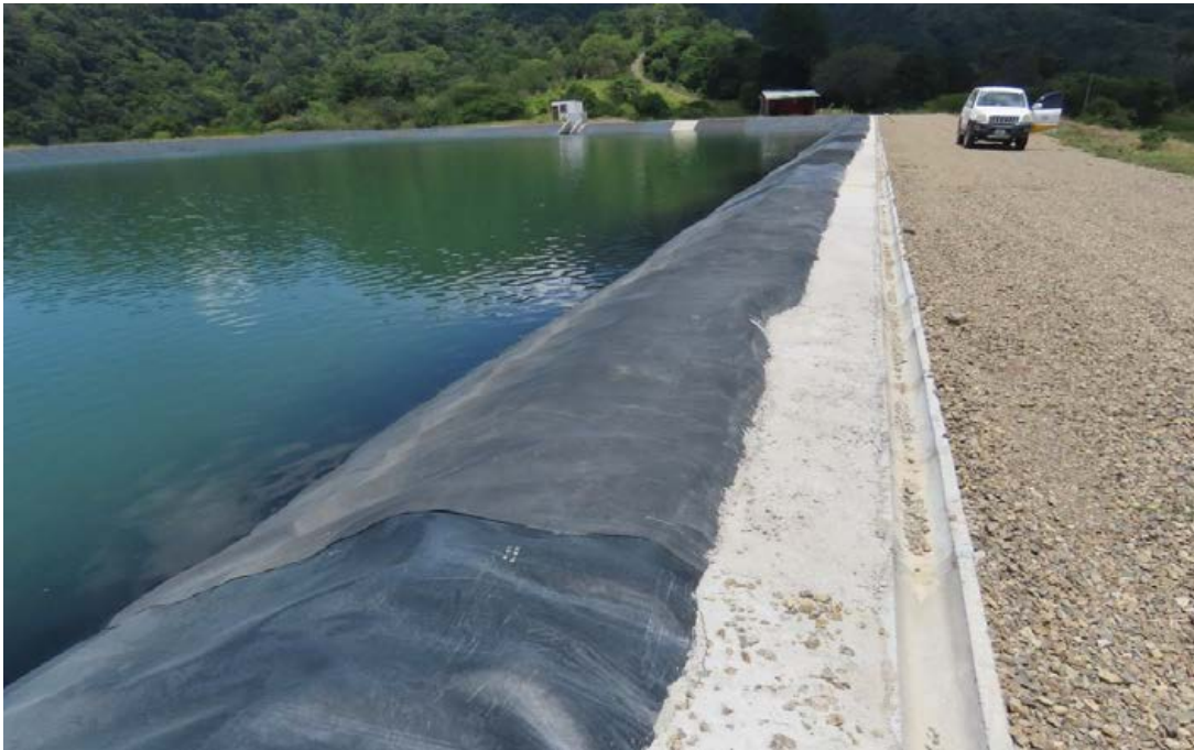
Figura 119. Laguna de almacenamiento de agua de trabajo.
