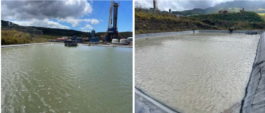
Figura 28. Lagunas impermeabilizadas en PLB-08
