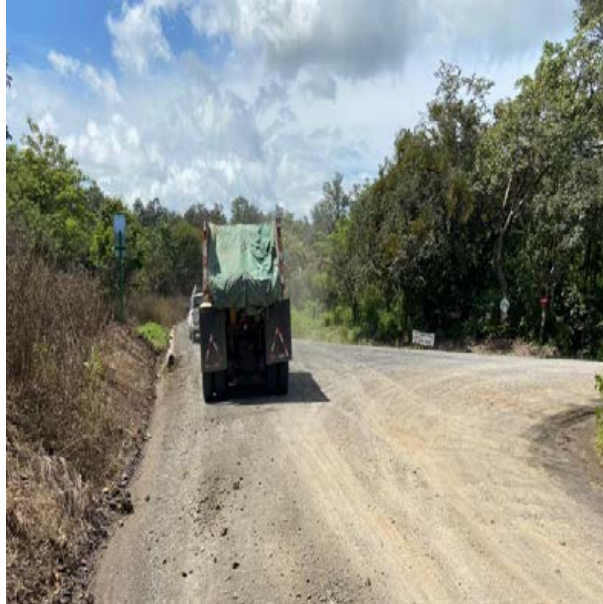
Figura 107. Circulación de vagoneta con el respectivo cobertor.
