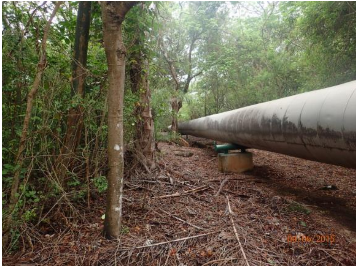
Figura 4-4: Tubería Bifásica en el Campo Geotérmico Miravalles en Bosque Secundario en un Potrero Histórico
