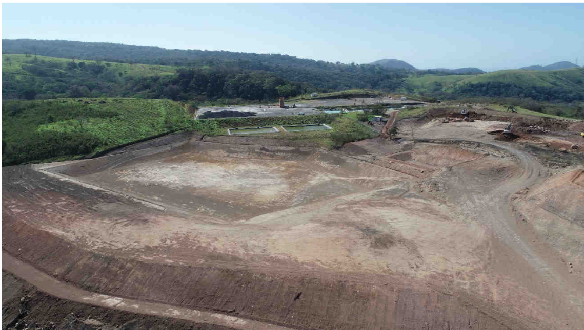
Excavación en sitio de obra Laguna LGB-02 y Estación Separadora ESB-02. Enero 2024.
