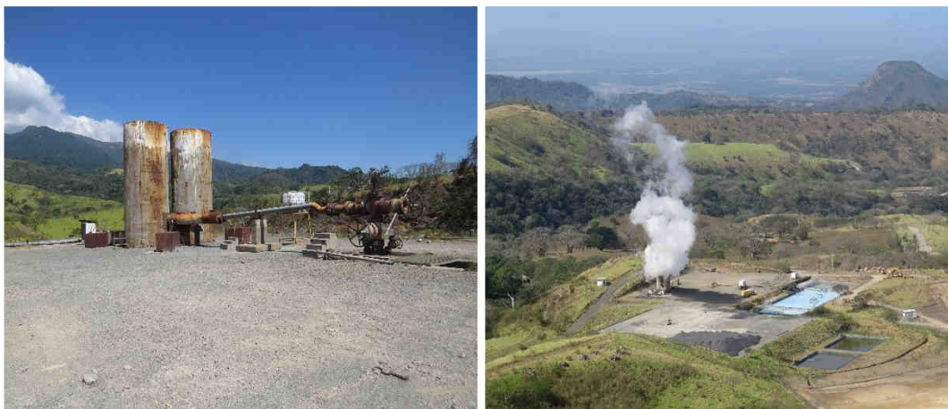
Figura 25. Sistemas de silenciadores colocados en pozos productores en el PG Borinquen (PLB-02).
