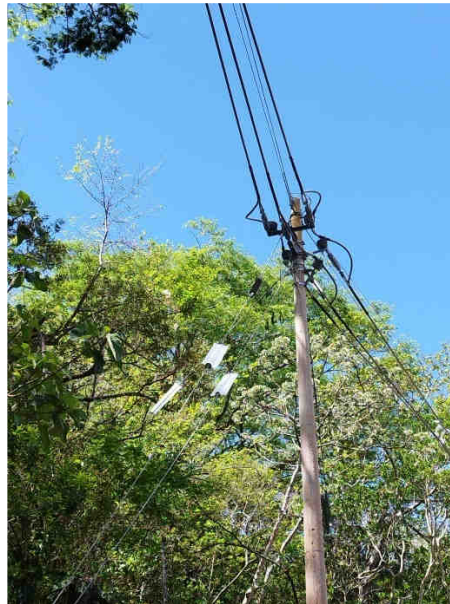
Figura 162. Dispositivos antiescalamiento. Proyecto Geotérmico Borinquen.
