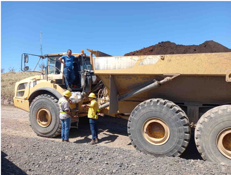
Inspección aleatoria de kit para atención de derrames, durante visita de regencia ambiental al PG Borinquen. Febrero 2024.
