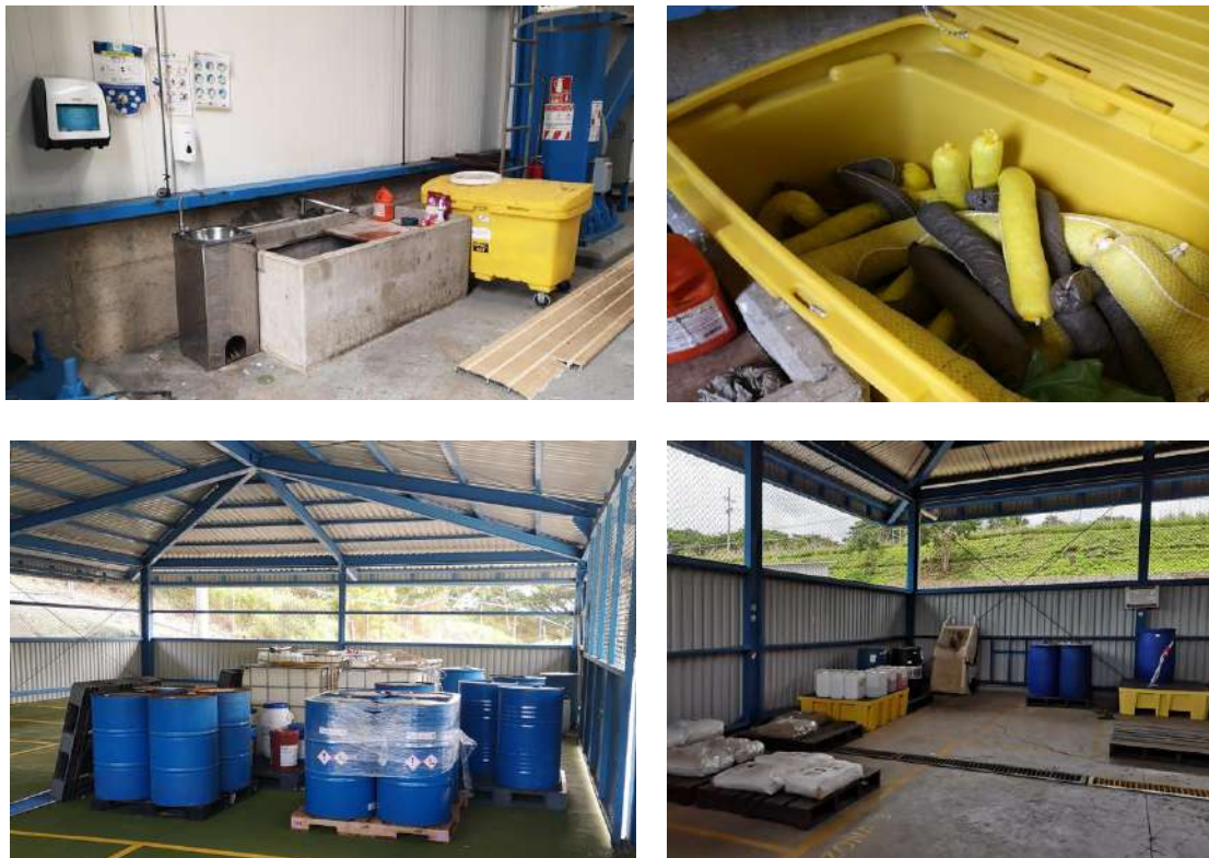
Figura 11 Zonas de almacenamiento de sustancias y pileta de lavado de equipos. Estas áreas están confinadas y dirigen las aguas al tanque de neutralización
