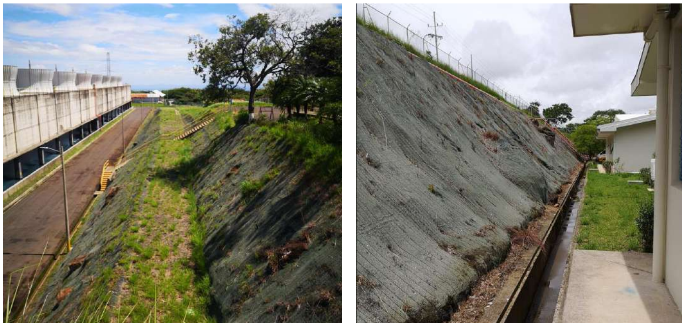
Figura 71 Estado estable y reparación de geomembrana de los taludes en Unidad I
