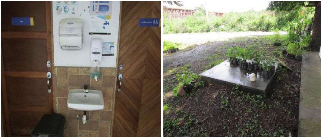
Figura 12. Estado de servicios sanitarios y tanque séptico utilizado en el CG Las Pailas.
