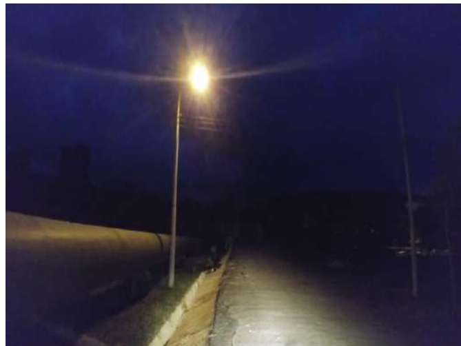
Figura 28 Iluminación en caminos
