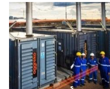
Reemplazo de diésel
